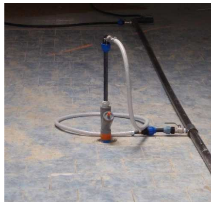
Tête de puits hors sol
