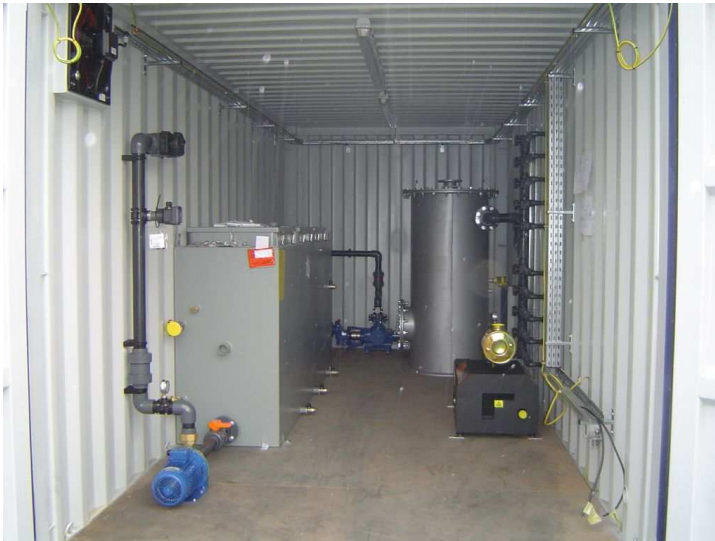
Intérieur du container d'une EMP
