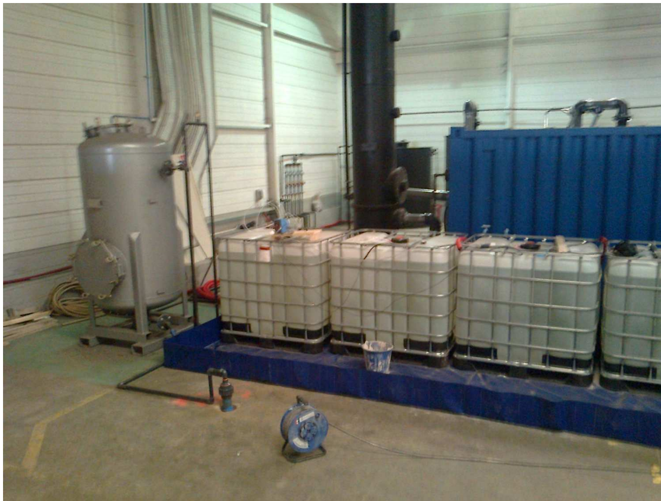
Unité de pompe-traitement/injection de lactate
